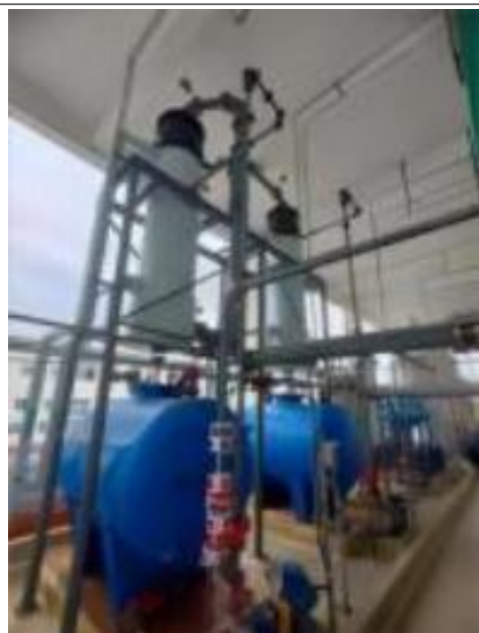
石墨冷凝器+活性炭吸附
