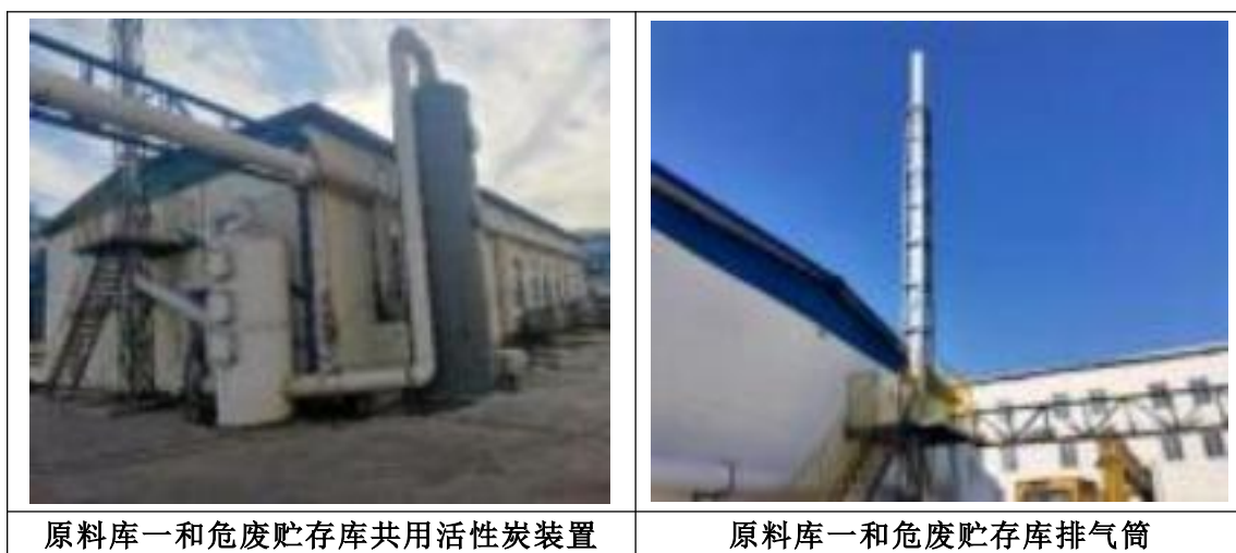
图 5.3-6 原料库一及危废贮存库废气治理措施图
